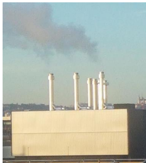
chaufferie bois Surville-Gerland –Sud de Lyon
